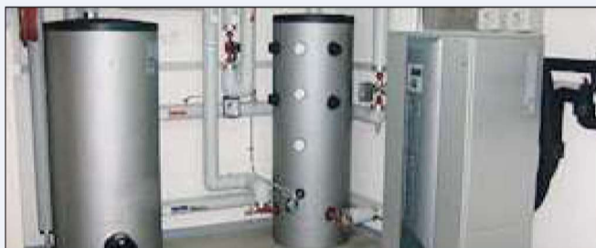
Pompe à chaleur/chauffage.
