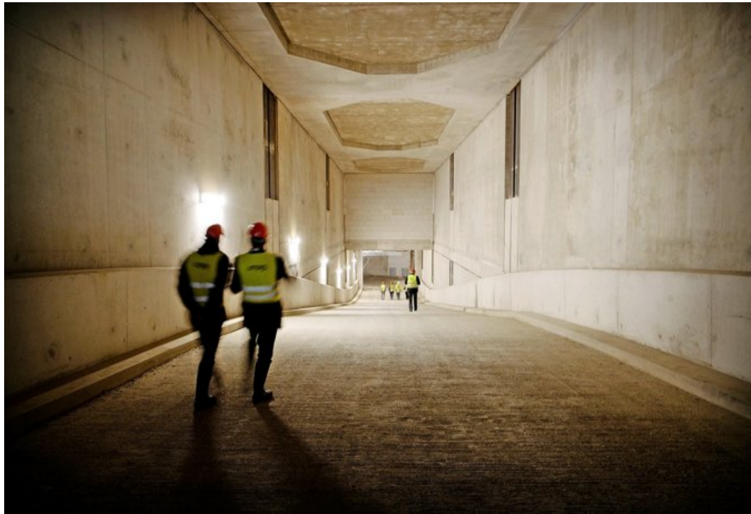
Le chantier d'En Chardon, ici en mai 2018, animera la session du Grand Conseil. LAURENT GUIRAUD
